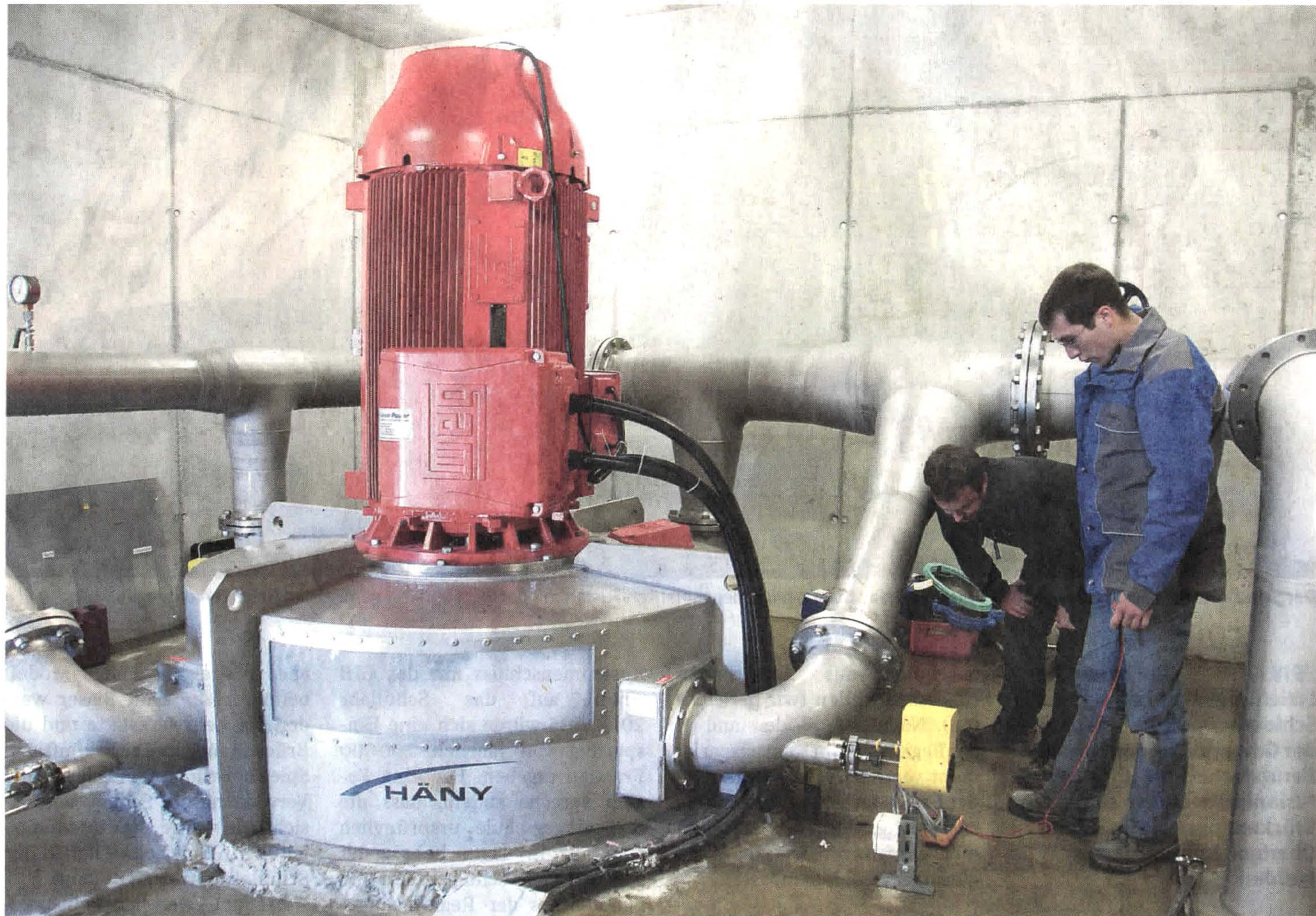
Die Turbine (unten) und der Generator (rot), mit welchen auf der Alp Blattenheid Strom produziert wird.
