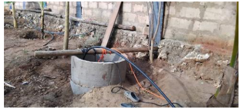
Ausgestaltung mit Brunnenringen und Bohrlochpumpe
