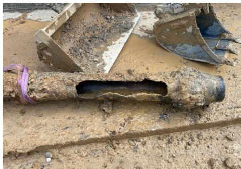
Leitungsbruch in Uttigen Dorfstrasse
