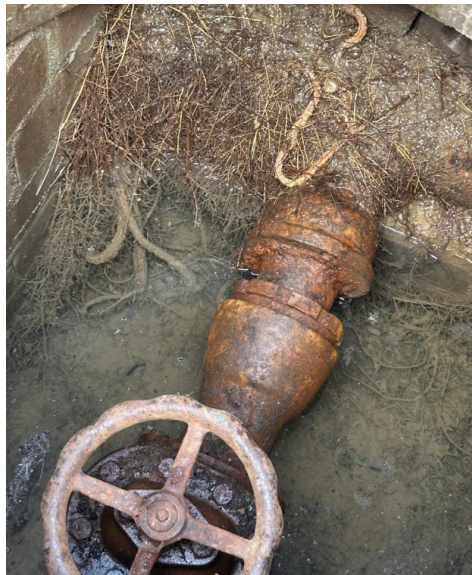
Undichte Muffe in Kiesen Schieberschacht
