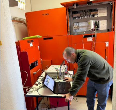
Wartung der 16 kV Anlage
